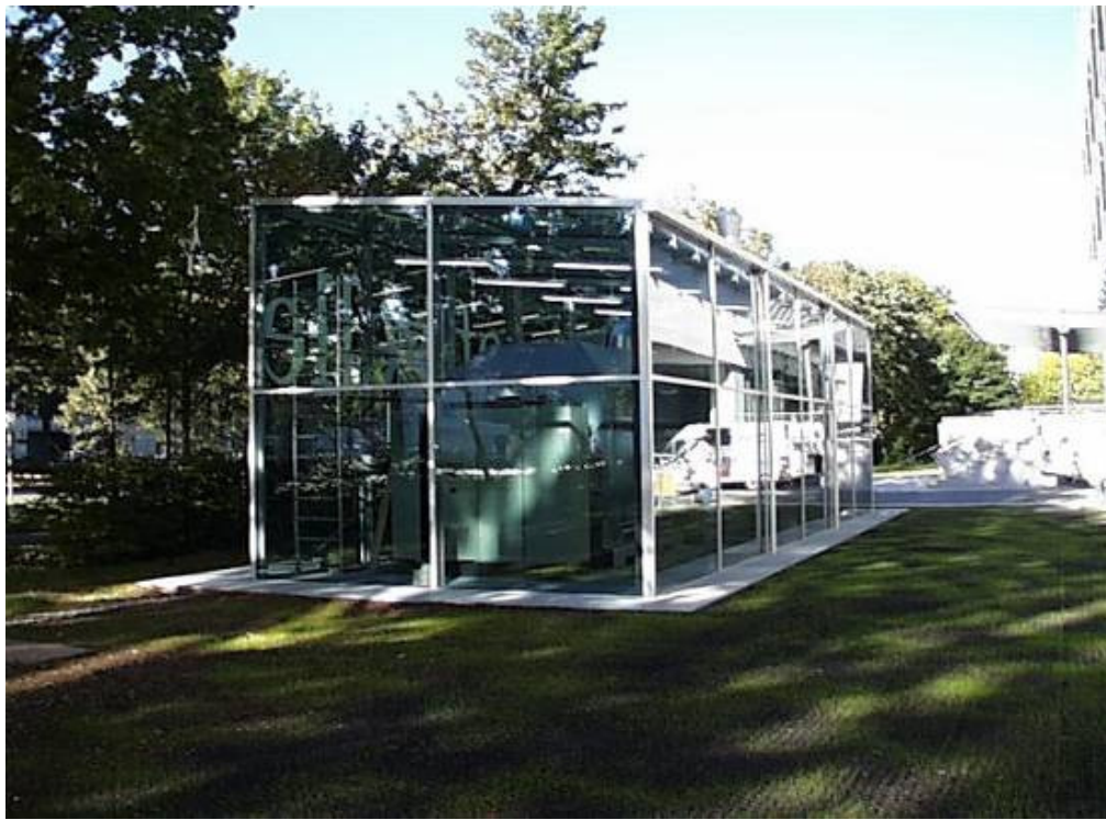
Feldversuchsanlage mtu HotModule Brennstoffzelle bei DeTe Immobilien
