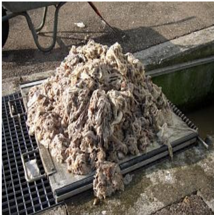
Foto 2: Rechenguteintrag der Kläranlage Rheinfelden binnen 4 Stunden
