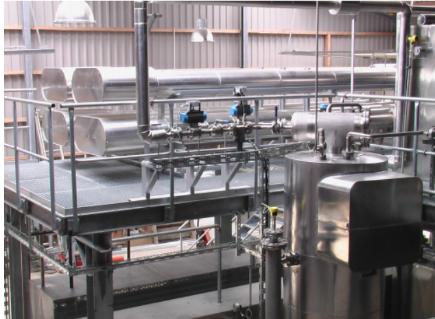
Bild 6 TDH®-Anlage zur Vorbehandlung biogener Reststoffe (Jahresdurchsatz ca. 35.000 t/a)
